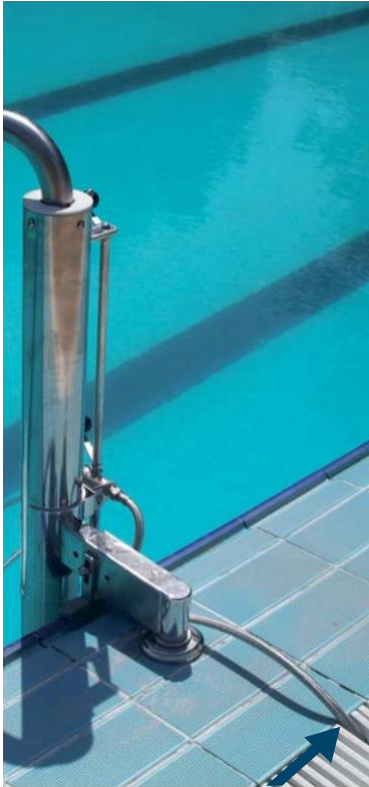
Detalle toma de agua
